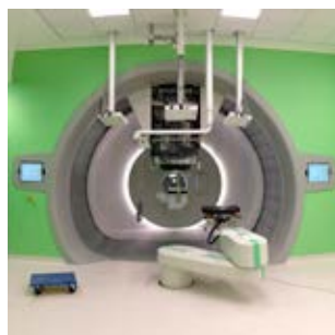
Centroprotonico Trento, sala trattamento
